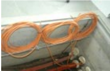
Figura 7. Reserva de cable
